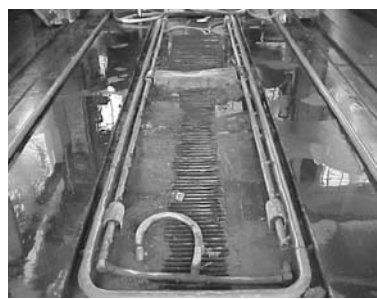
Rejilla desarenadora sin mantenimiento de limpieza
