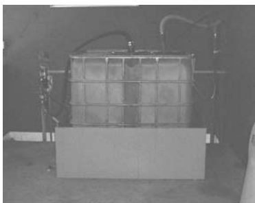
Almacenamiento transitorio de residuos líquidos con batea de contención
