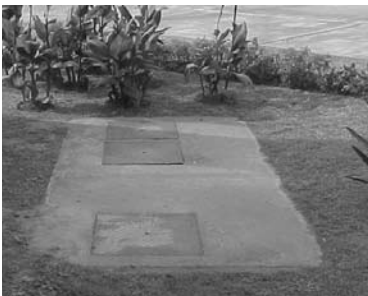
Cámara de tratamiento de efluentes. Vista exterior
