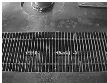
Rejilla desarenadora limpia
